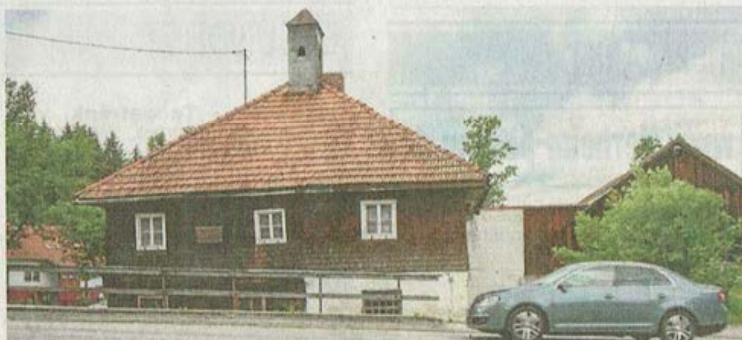
Die Staatsstraße 2132 bedroht die Bausubstanz des Paul-Friedl-Hauses.
